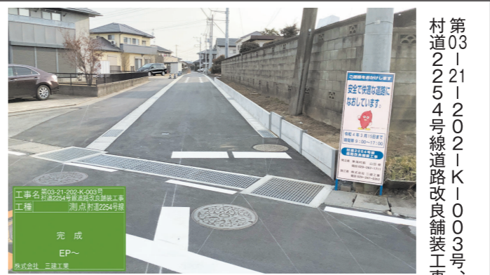
第0312112021K1003号 村道2254号線道路改良舗装工事 (社)茨城県交通安全施設業協同組合員 交通安全施設塗装工事、区画線、標識、土木、舗装、水道、管工事、ガードレール、カーブミラー 株式会社 三建工業 代表取締役 三原 章裕 本社 〒319-1102 茨城県那珂郡東海村石神内宿2265-2 TEL 029-287-0352 FAX 029-287-2408 E-mail:kabu3ken@be.wakwak.com
