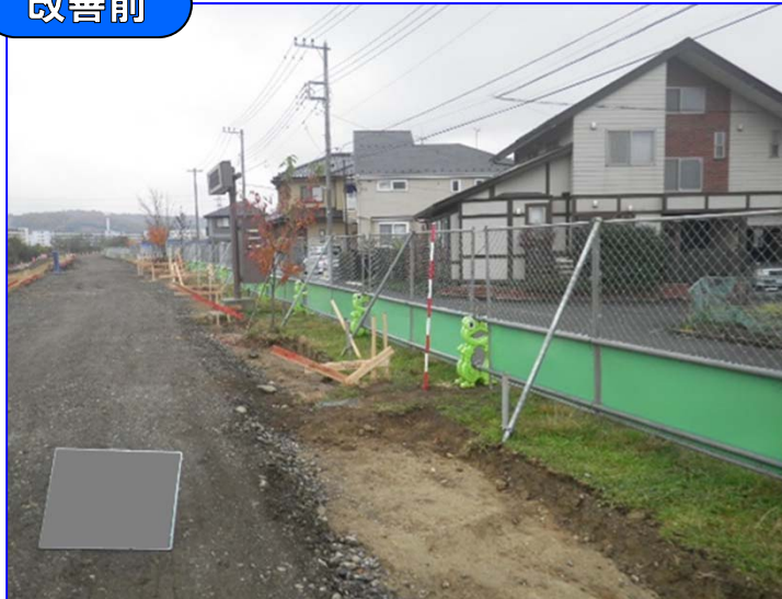
埋設物の有無が示されていない
